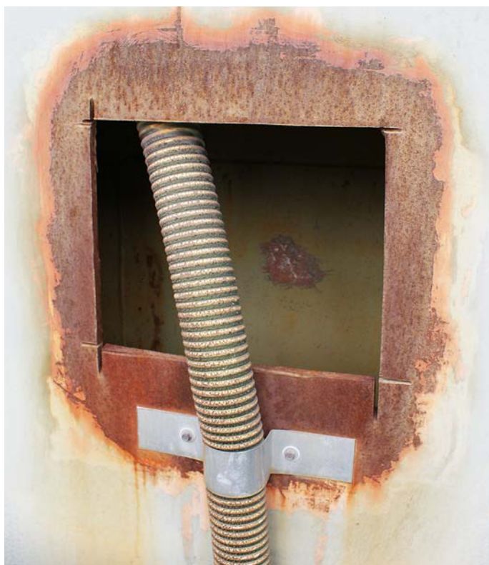
Exemple de produit anticorrosif contenant des PCB. Photo : EMPA.
