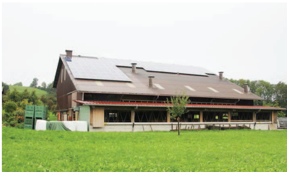
Das Scheunendach wird «vermietet». Die Eltern und Geschwister von Andrea betreiben darauf eine Photovoltaikanlage, welche eine maximale Leistung von 30 kWp hat.
